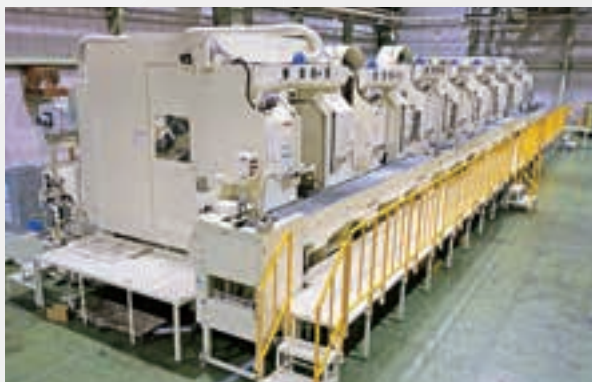
コンベア Conveyor
