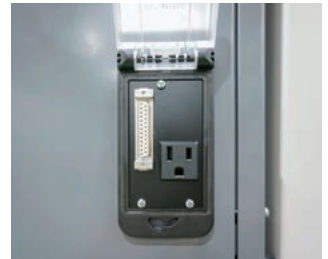
操作盤 100V コンセント Operation panel 100V outlet
