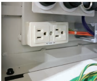
制御盤 100V コンセント Control box 100V outlet
